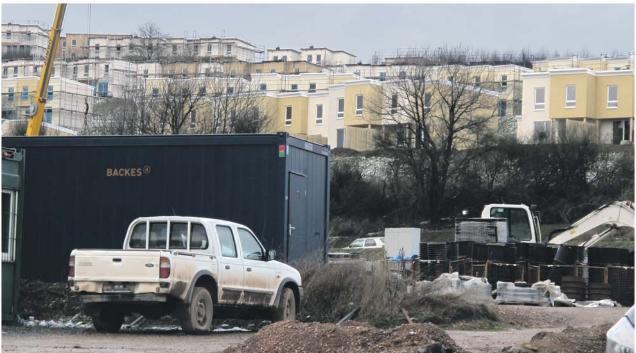
Etwa 370 Häuser sind am Bostalsee inzwischen errichtet. Täglich werden etwa zwei Häuser zusammengebaut.
