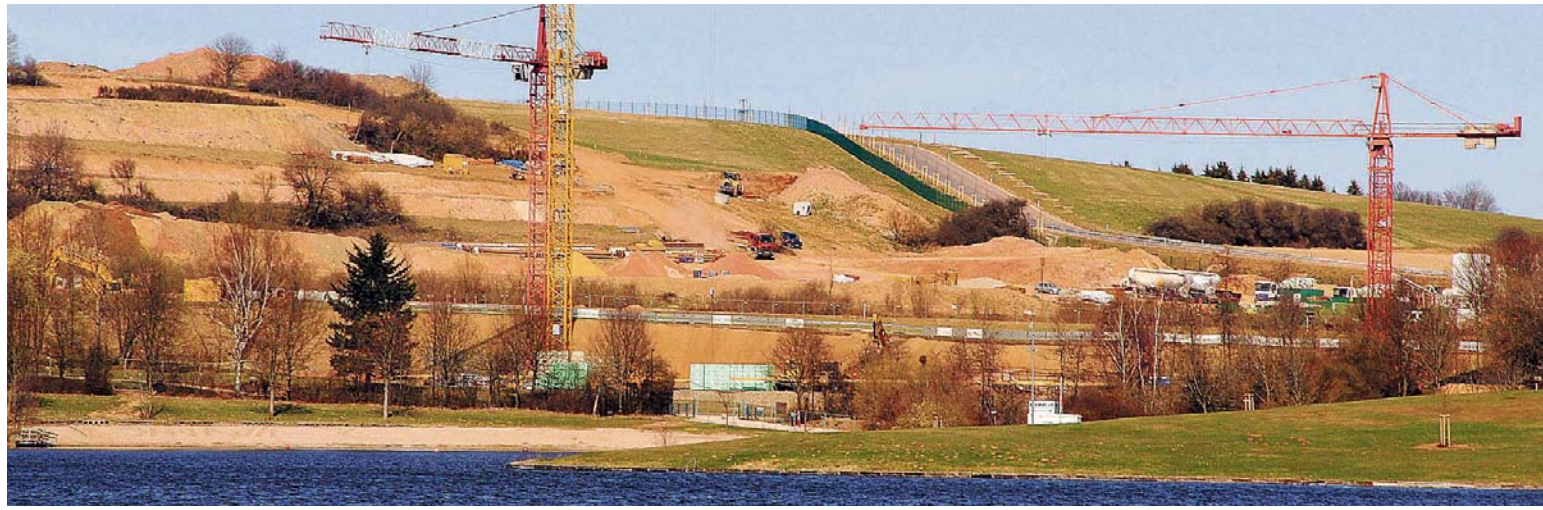
Blick vom Bostalsee auf das Strandbad Gonesweiler, die Liegewiese (im Vordergrund) und die Baustelle des Ferienparkes. FOTO: B&K
