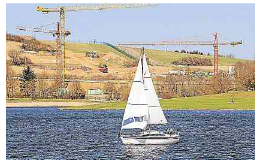
Der Ferienpark am Bostalsee nimmt Gestalt an: Hier ein Blick von der Staumauer auf die Großbaustelle.
