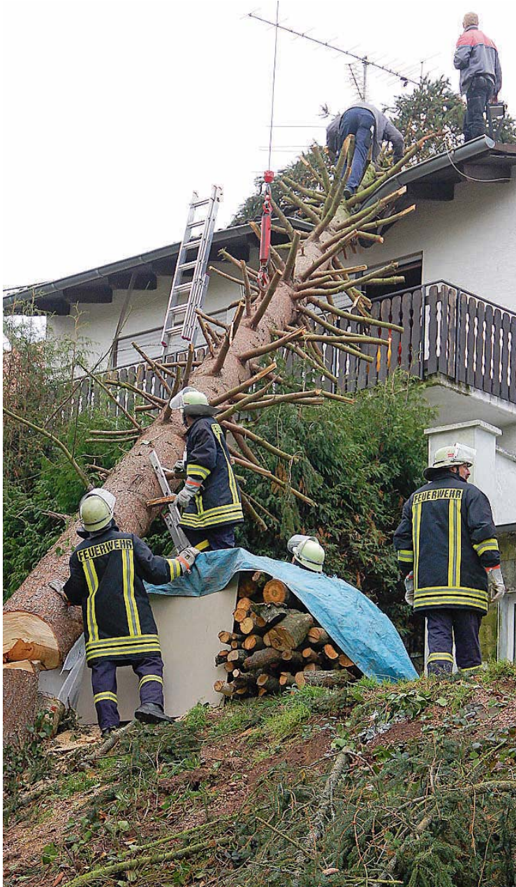
Dieser Baum stürzte, anders als geplant, in die Richtung des Hauses und beschädigte Dach sowie Balkon. Feuerwehrleute hatten Schwerstarbeit zu leisten. FOTO: BONENBERGER & KLOS
